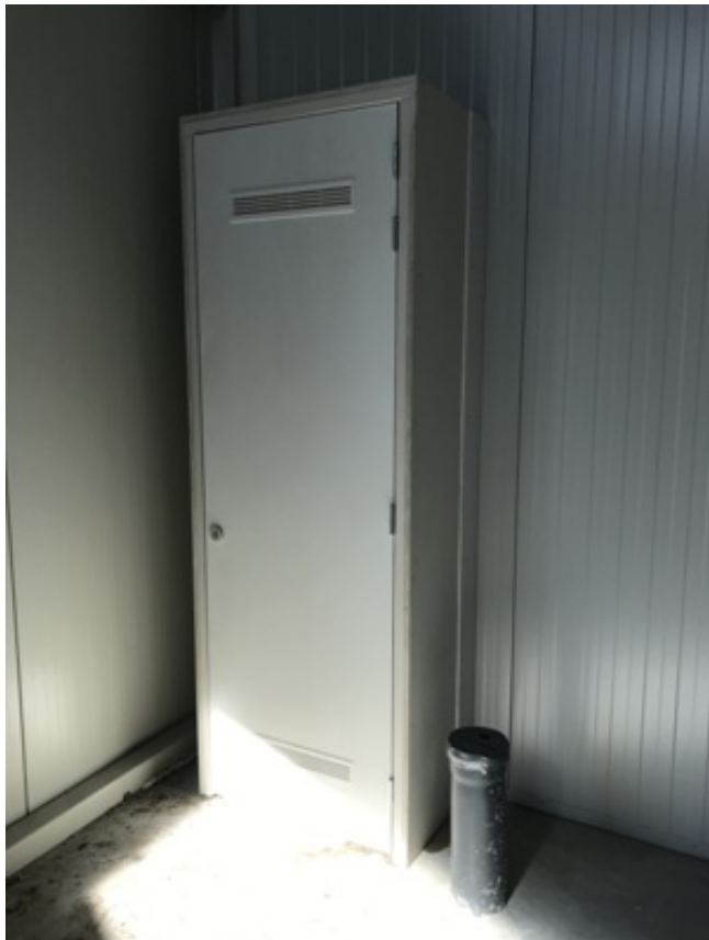
Standaard meterkast + riool (referentiebeeld)
