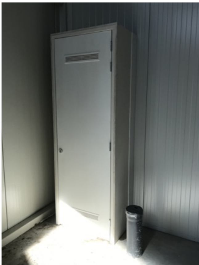
Standaard meterkast + riool (referentiebeeld)
